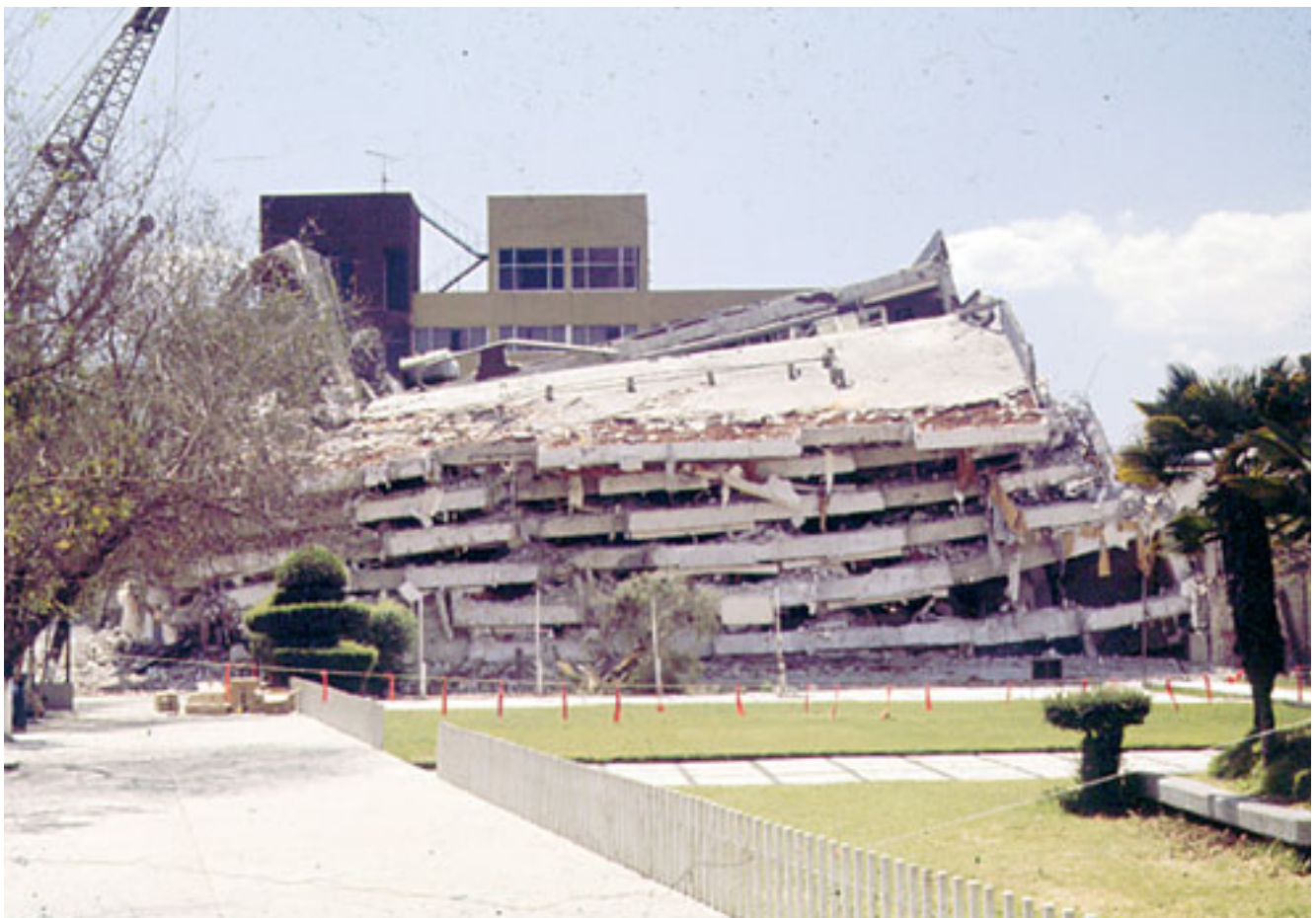
México 1985. Colapso del Hotel Finisterre, calle "Calzafa Talplan (foto de A. G. Y.)
